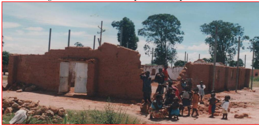
Figura 2: Escombros do Templo destruído pelas chuvas.
